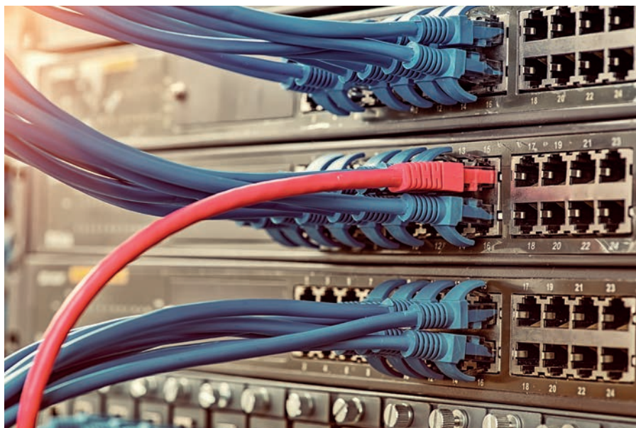
Commutateurs Ethernet montés en rack et alimentés par des câbles Ethernet à huit fils.
